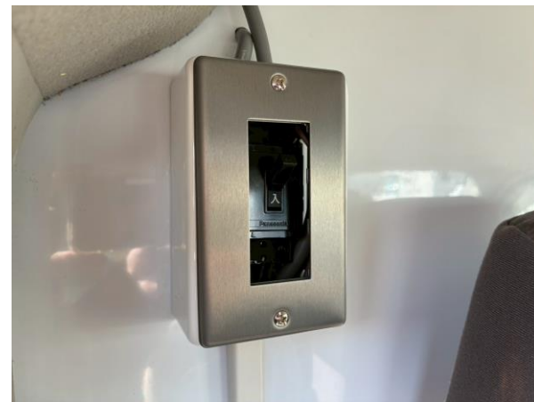
外部電源引き込みブレーカー
