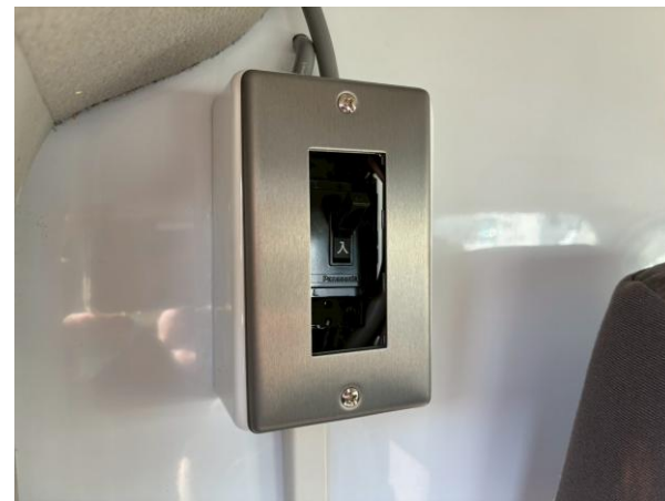
外部電源引き込みブレーカー
