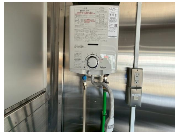
ガス式給湯器
