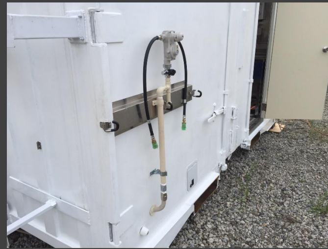
LPガス50kg 固定フック
