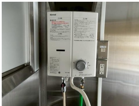
ガス式給湯器
