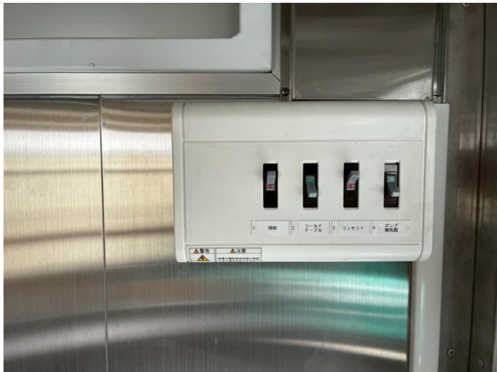
外部電源引き込みブレーカー
