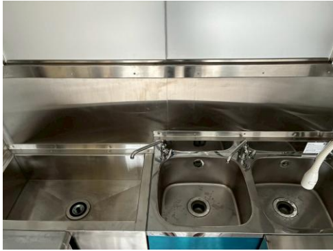
2槽シンク＋手洗いシンク
