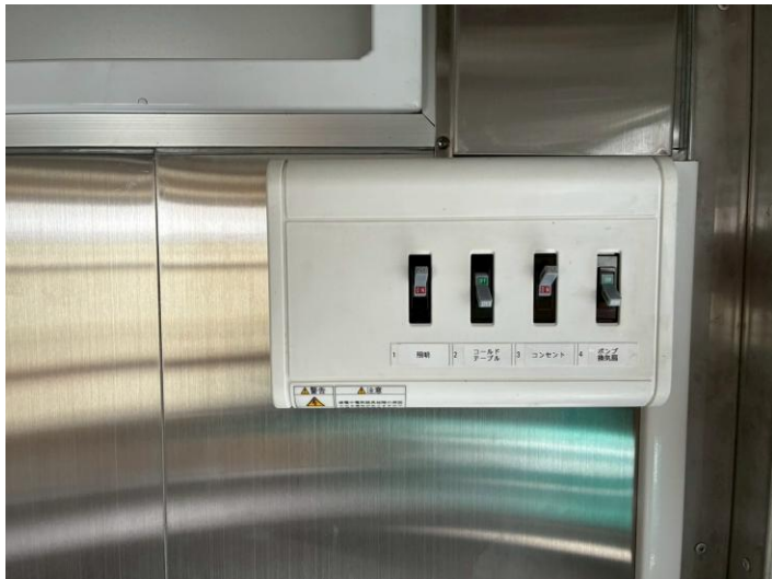
外部電源引き込みブレーカー
