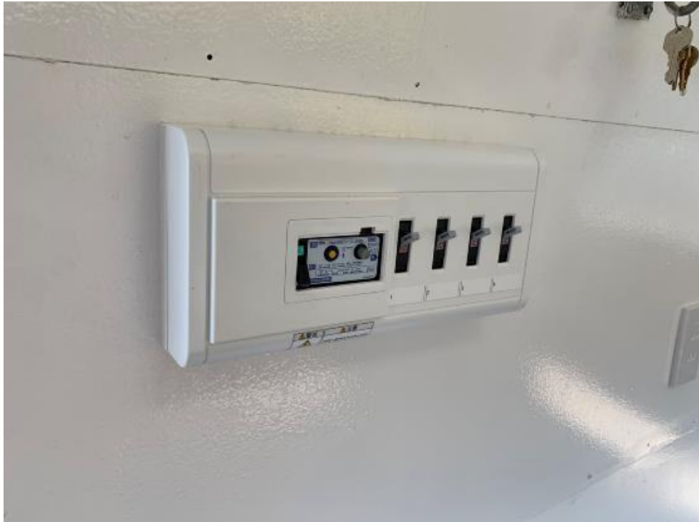
外部電源引き込みブレーカー
