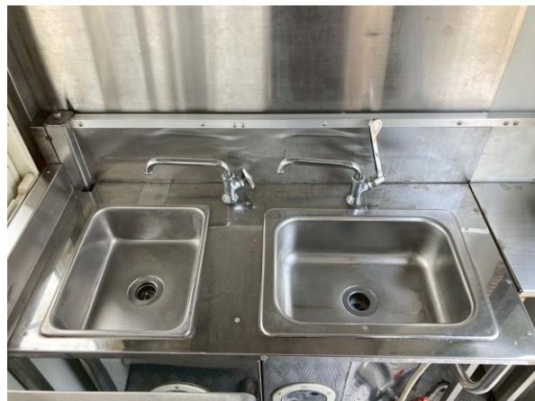
1 槽シンク + 手洗いシンク
