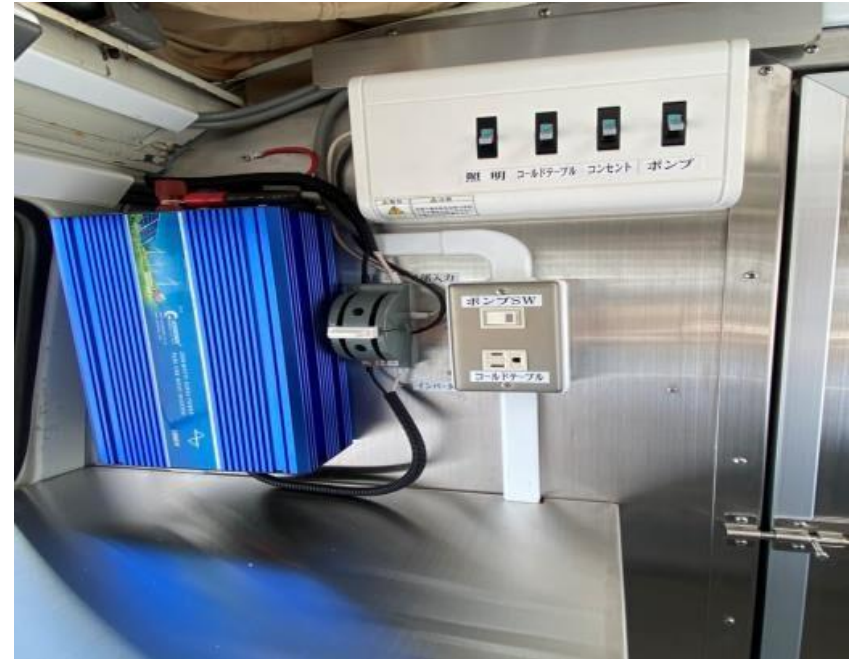
外部電源引き込みブレーカー
