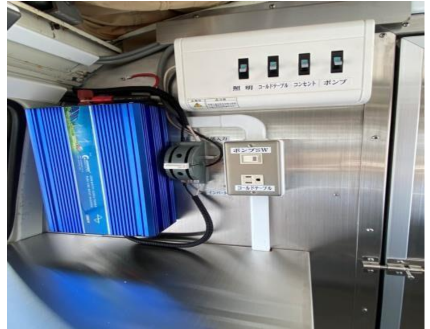
外部電源引き込みブレーカー
