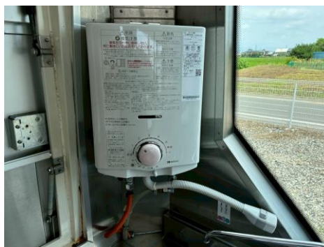
ガス式給湯器
