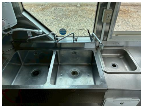
2槽シンク＋手洗いシンク
