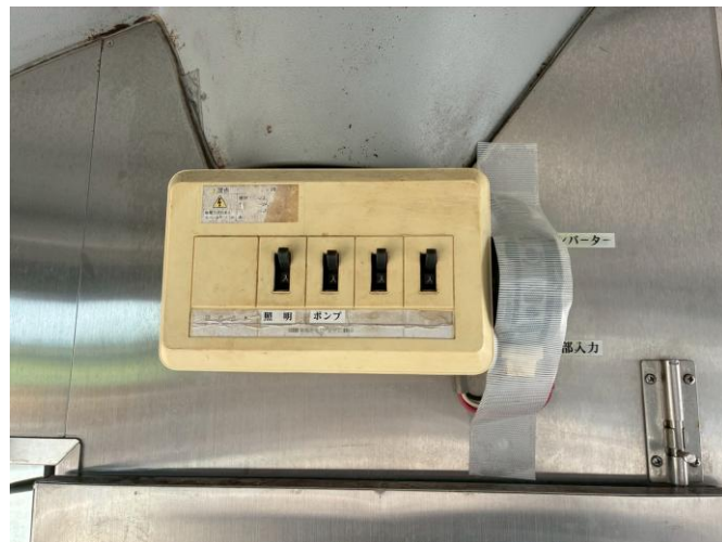
外部電源引き込みブレーカー
