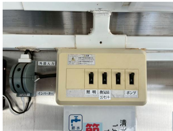
外部電源引き込みブレーカー
