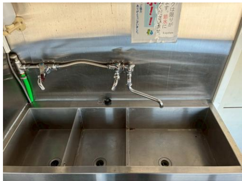
2槽シンク＋手洗いシンク
