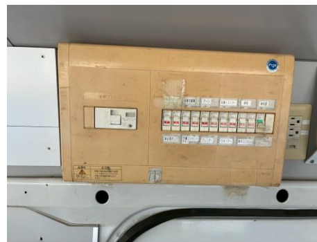
外部電源 引き込みブレーカー
