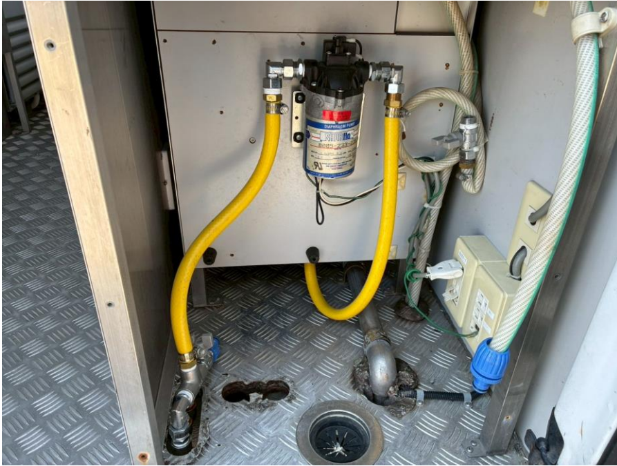
給水口 直結ホース
