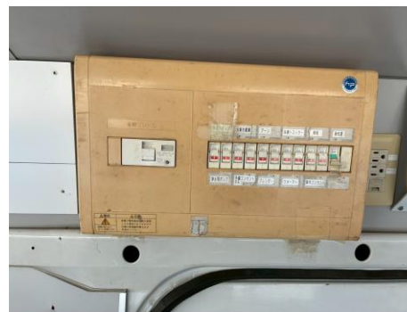
外部電源 引き込みブレーカー
