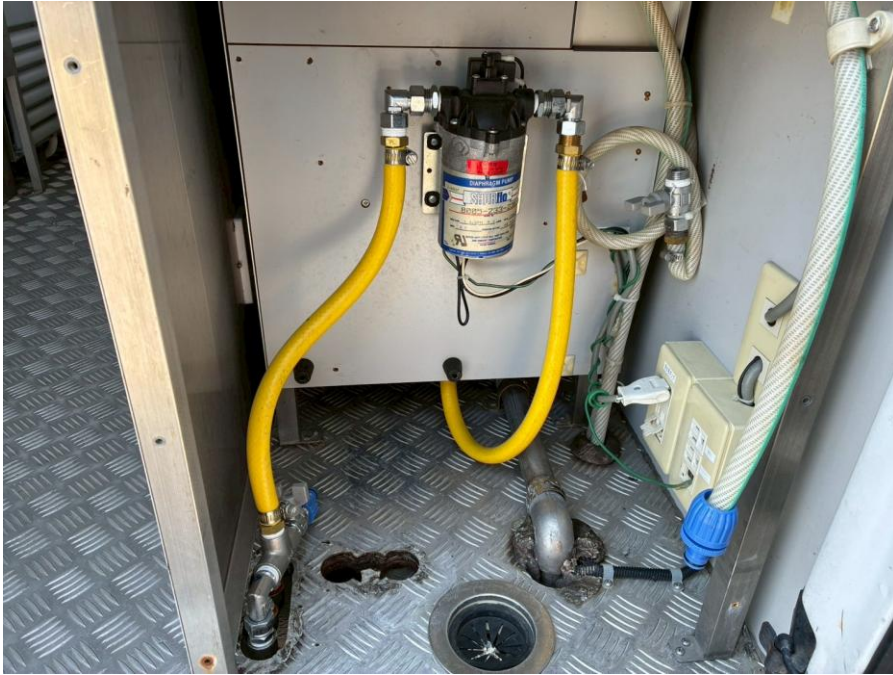
給水口 直結ホース
