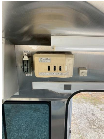
外部電気引き込みブレーカー
