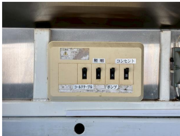
外部電気引き 込みブレーカー
