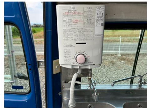
ガス式給湯器
