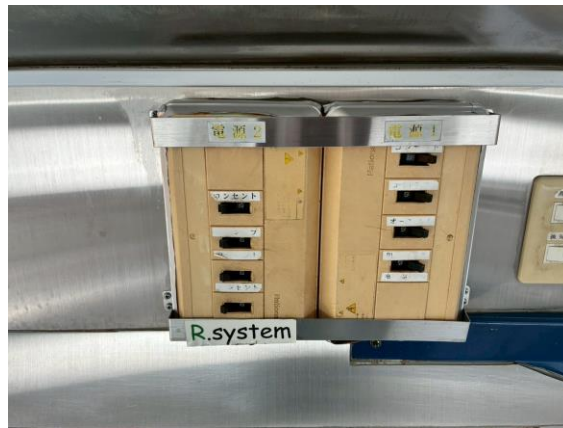
外部電気引き込みブレーカー
