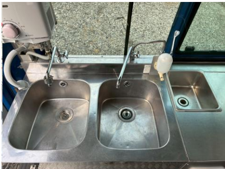
2槽シンク+手洗いシンク
