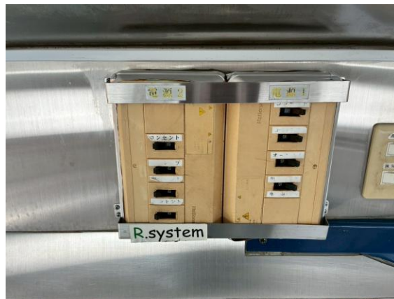
外部電気引き込みブレーカー
