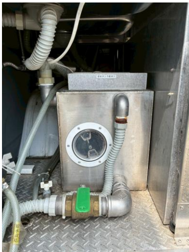
排水タンク (200ℓ) 給排水口 + 直結ホース
