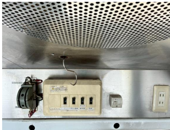
外部電気引き込みブレーカー
