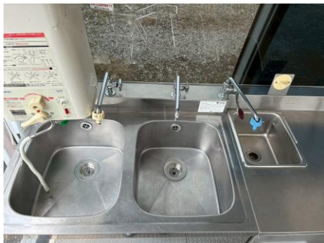
2槽シンク+手洗いシンク
