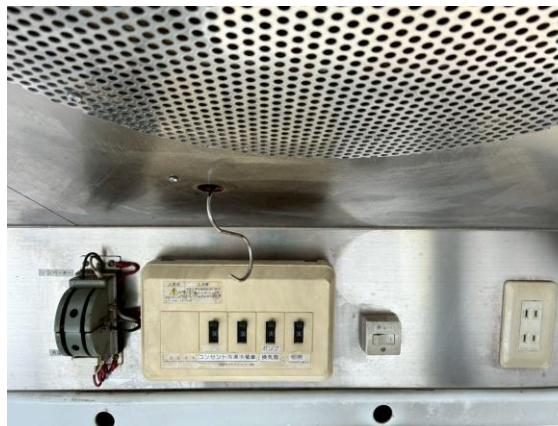
外部電気引き込みブレーカー
