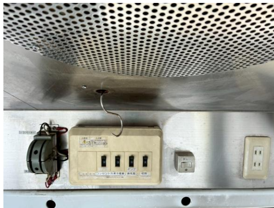
外部電気引き込みブレーカー
