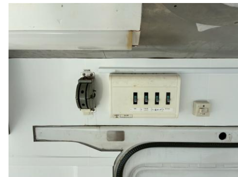
外部電気 引き込みブレーカー
