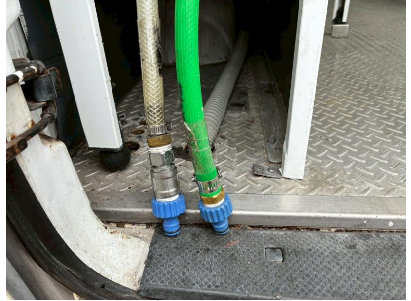
給水口 + 直結ホース
