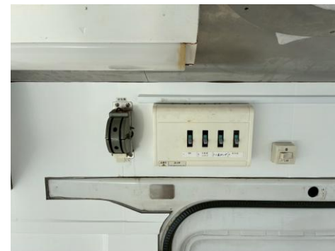
外部電気 引き込みブレーカー
