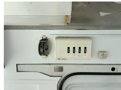
外部電気 引き込みブレーカー
