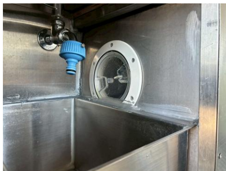
給水タンク 手洗いシンク
