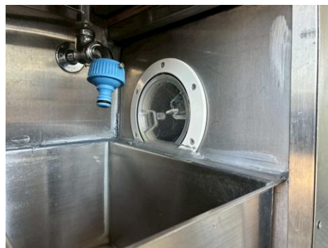
給水タンク 手洗いシンク
