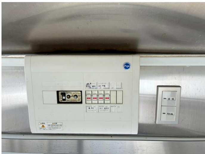
外部電源引き込みブレーカー
