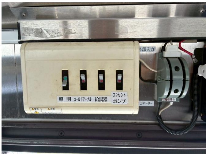
外部電気引き込みブレーカー
