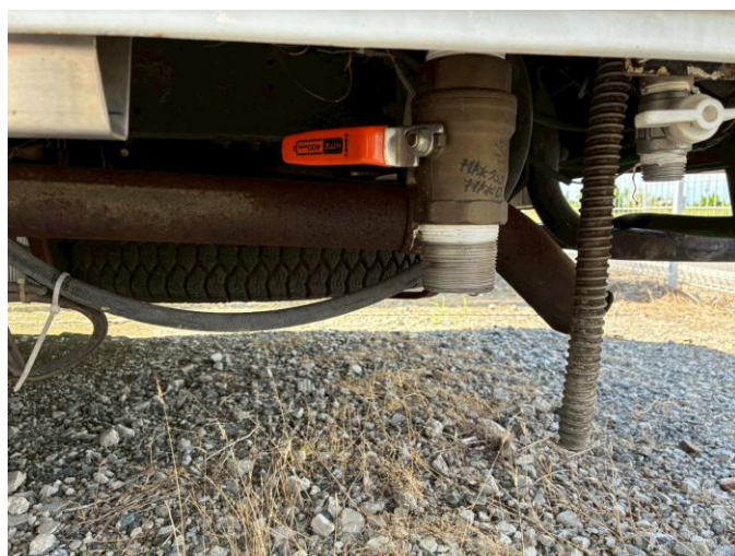
排水口 + 直結ホース
