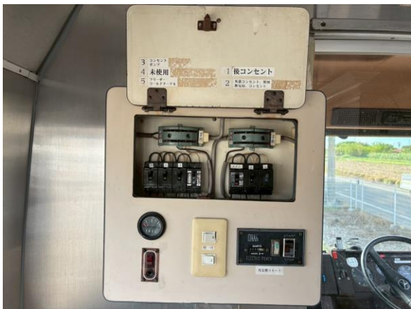
外部電気引き込みブレーカー
