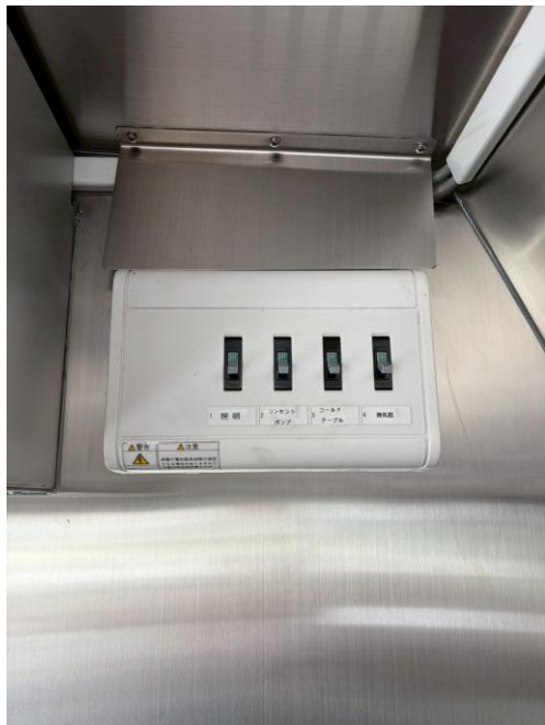
外部電気引き込みブレーカー
