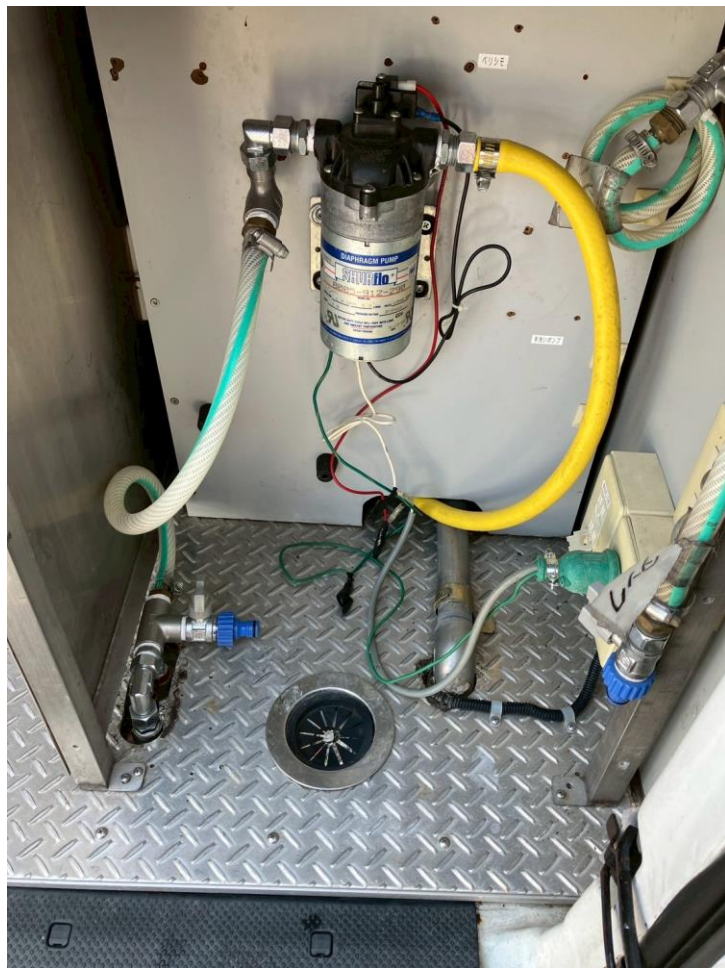
給水口 直結ホース
