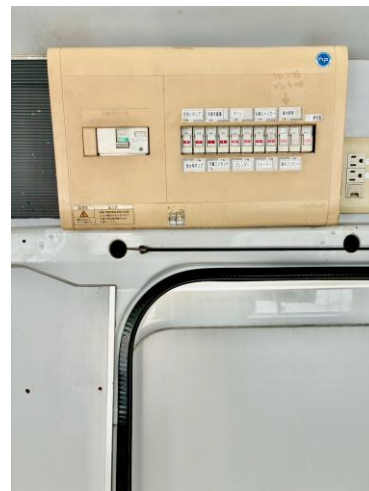
外部電源 引き込みブレーカー
