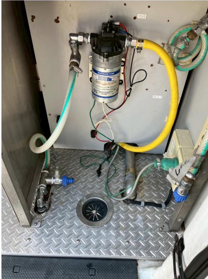
給水口 直結ホース
