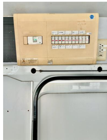
外部電源 引き込みブレーカー
