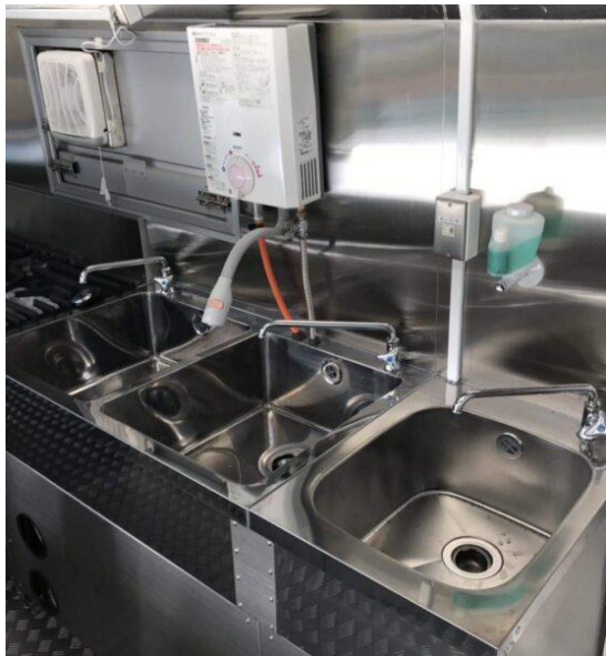
2 槽シンク + 手洗いシンク
