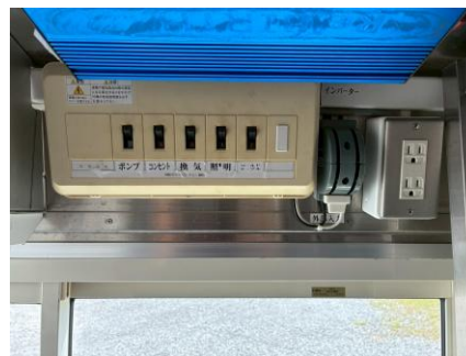
外部電気 引き込みブレーカー
