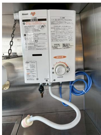
ガス式給湯器
