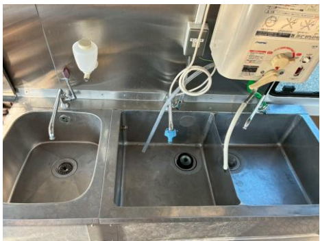
2槽シンク 手洗いシンク
