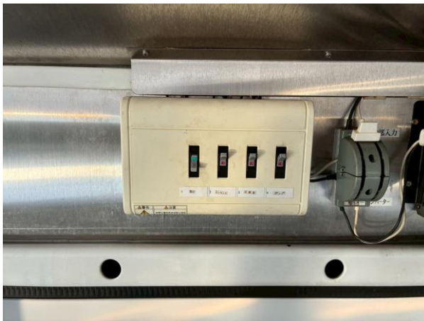
外部電気引き込みブレーカー
