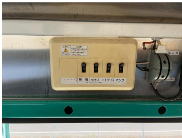
外部電気引き込みブレーカー
