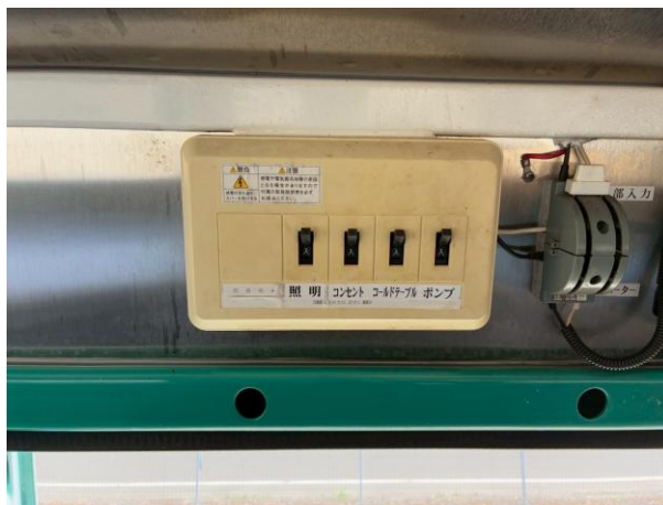
外部電気引き込みブレーカー
