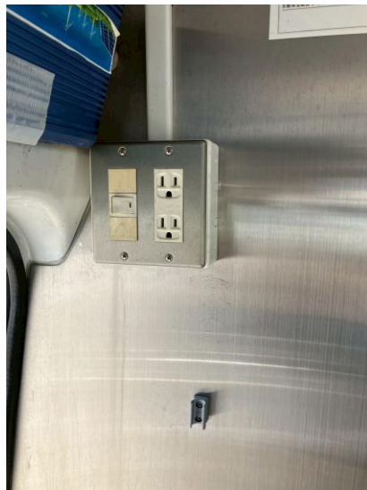
外部電気引き 込みブレーカー
